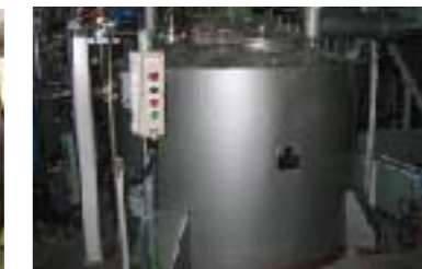
液処理設備(反応槽)
