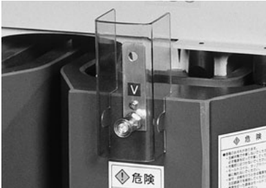
高圧端子部絶縁カバー
